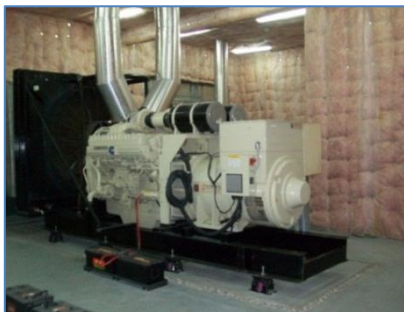
Planta de Energía eléctrica del Edif. Norge Botello
