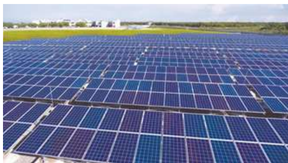
Fig. 4.8. Planta Fotovoltaica del IDAC
